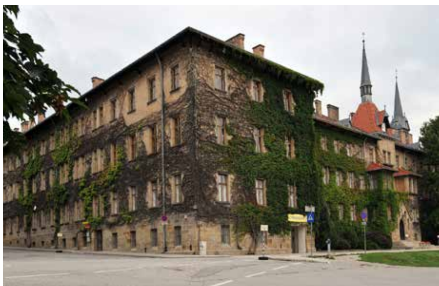
Das historisch wertvolle Schulgebäude des Sacré Coeur wird Zug um Zug akustisch ertüchtigt, um die Lehr- und Lernerfolge weiter zu verbessern.
